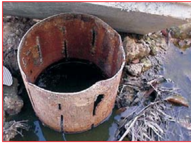
Fig. 21. Pozo de absorción.
