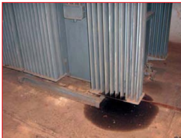
Fig. 34. Manejo inadecuado de transformadores eléctricos que contienen bifenilos policlorados (PCBs).
